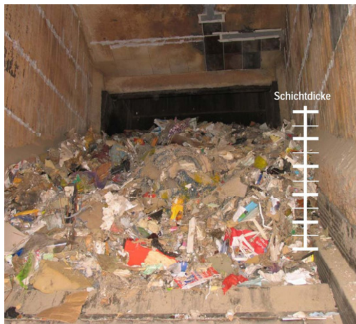
Abb. 2.5: Frischer, unverbrannter Müll unterhalb des Aufgabetisches (Schichthöhe maximal etwa 0,8 m bezogen auf die Randsteine)
