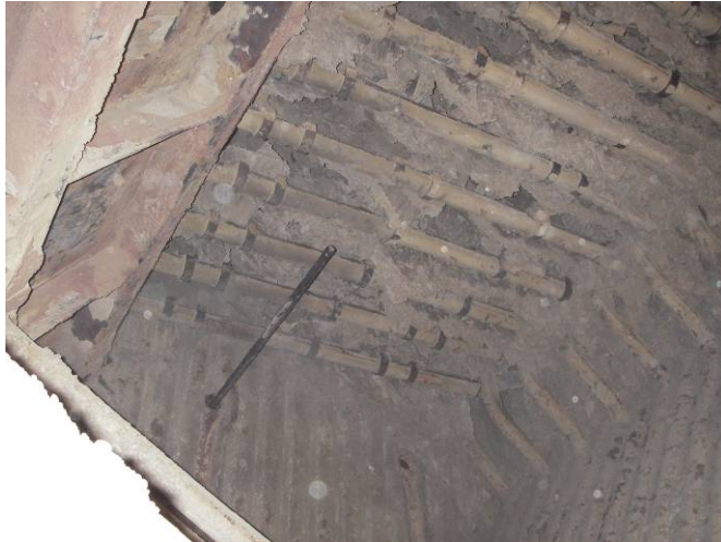
Zugesetzte Wärmefalle vor Eintritt ÜH
