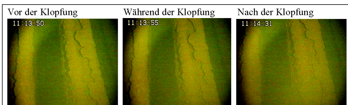
Abb. 16: Anströmseite eines Überhitzers (1. Bündel)
