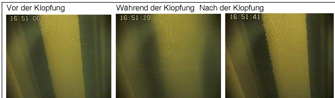
Abb. 21: Anströmseite eines Überhitzers
