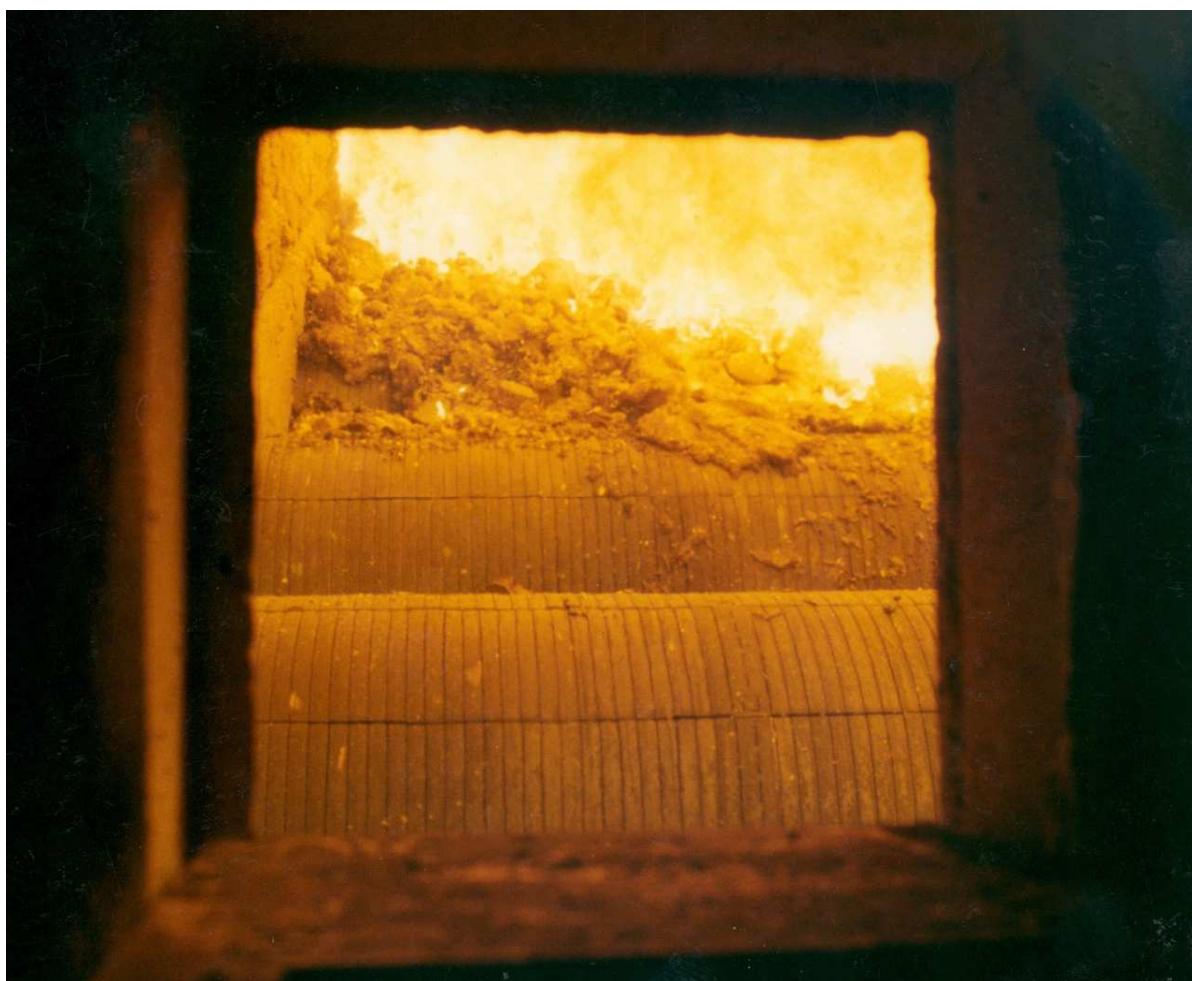
Abbildung 7: Blick in den Feuerraum eines Walzenrostes
