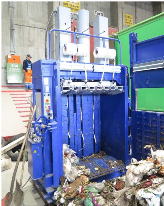
Abbildung 32: Portalpresse nach einem Pressversuch mit Brennstoff Hausmüll
