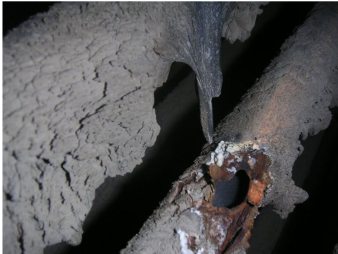
Abb. III-68: Rohrreißer in einem Überhitzerbündel
