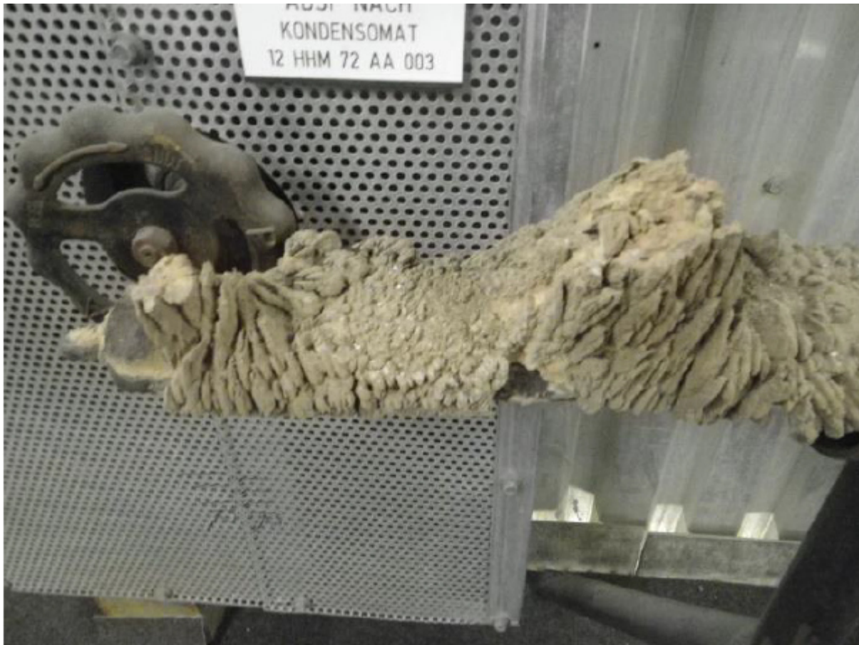
Abb. III-103: Korrosionssonde nach einem Betriebsjahr [35]
